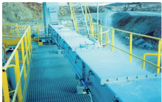
Vistas de sinfines verticales y transportador de husillos.
